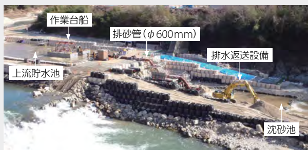
大口径(φ600mm)の排砂管により、河底に堆積した土砂を排砂する実証実験の設備
