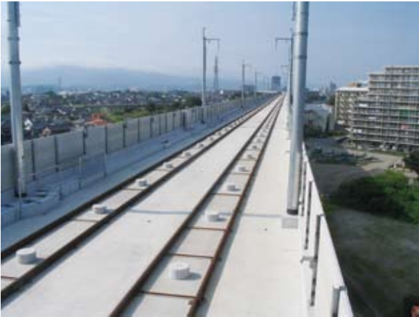
九州新幹線 久留米津福西高架橋 ('09) 所在地 / 福岡県久留米市
