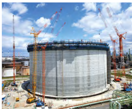
大阪ガス泉北製造所5号LNGタンク
