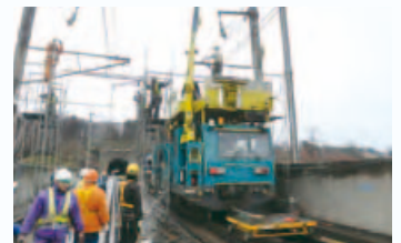
↑東北新幹線の早期運行再開をめざして、軌陸クレーンを使って電架柱を取り換える
