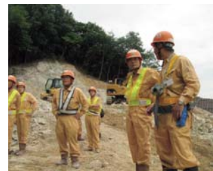
西脇トンネルの建設現場での特別パトロールの様子(2009年7月)
