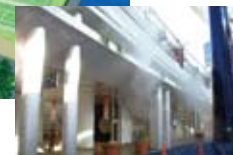
屋外細霧冷房システム
