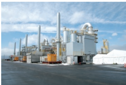
リサイクルできない廃棄物のうち可燃物は、現地に設置した処理施設で焼却
